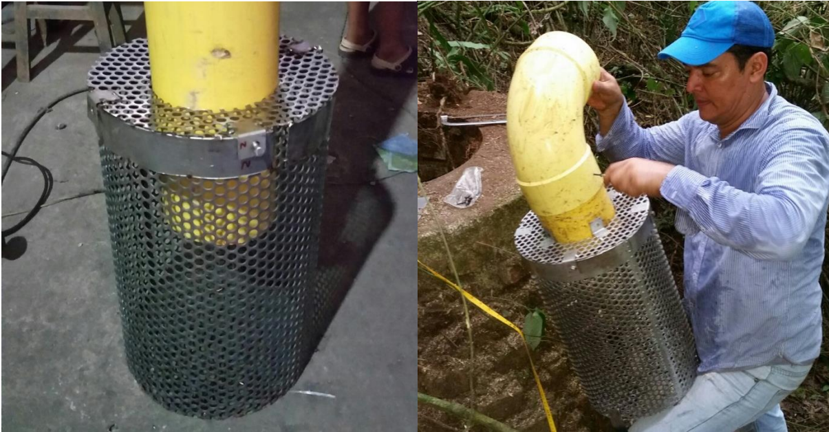
Imagen 11. Trampa de retención, Parte interior.
