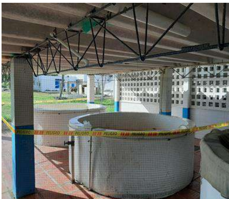
Foto 22 Tanques circulares unidad de tratamiento y disposición de vertimientos – Estación Piscícola del Bajo Magdalena - Repelón (Atlántico)
