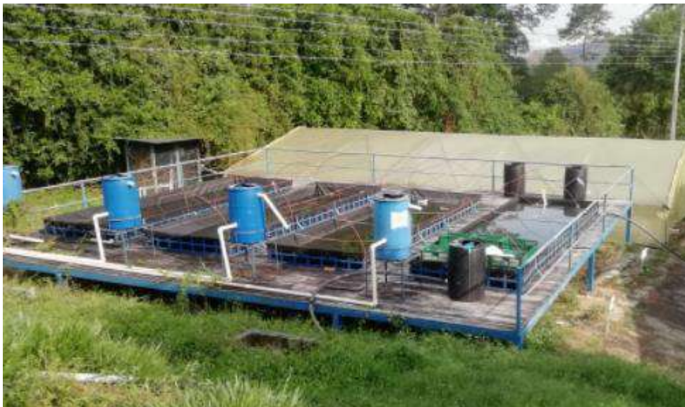
Foto 15. Área de tratamiento de agua Estación Piscícola del Alto Magdalena (EPAM) – Gigante (Huila).
